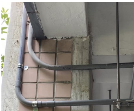
走廊以外使用PVC配管
